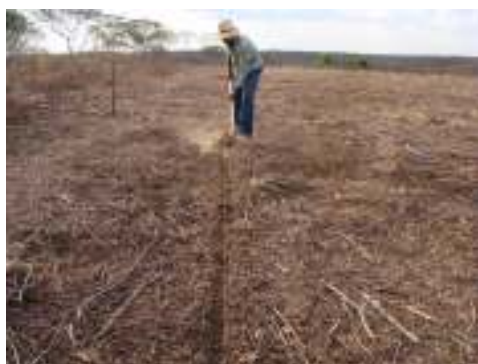
FIGURA 1. Preparo do Solo para instalação das UTDs no Sítio Baixio Verde, Salgueiro – PE
