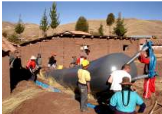
FIGURA 3. Biodigestor de PVC provisto de doble salida, para el sobrenadante y los sólidos sedimentados.
