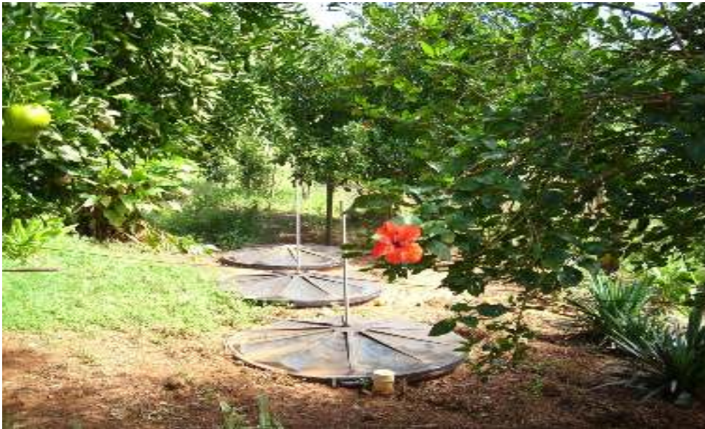
FIGURA 3. Fossa após dois anos de funcionamento, em maio de 2009.
