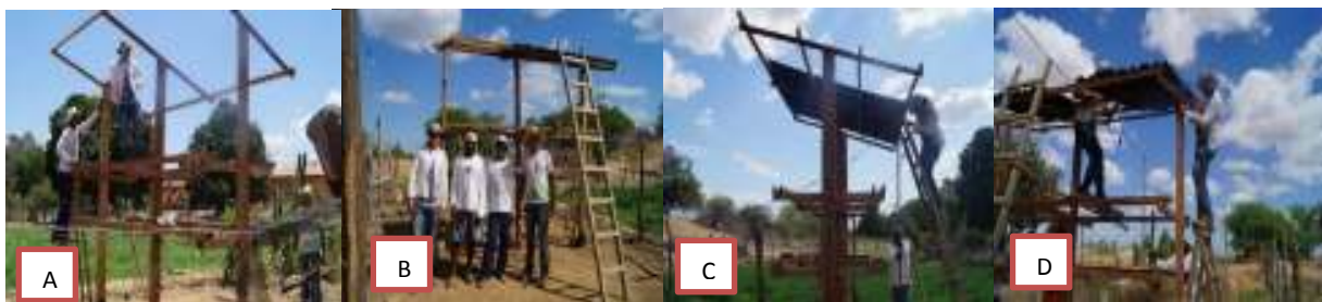
FIGURA 2: (A,B,C,D) Construção do meliponário com o auxílio dos estudantes do IF sertão-PE e moradores do Projeto Pontal Norte.
