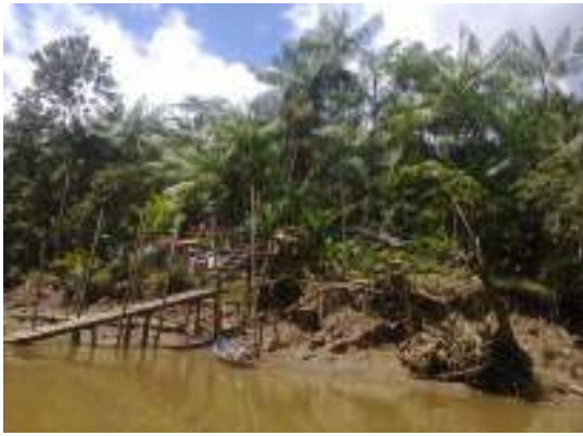
Foto1: O local em processo de erosão
